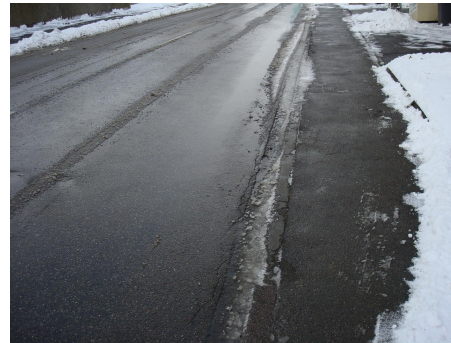
Abb.2 schadhafte Randsteine / Fahrbahn
